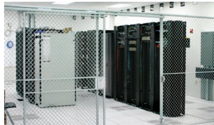
KCI DATA CENTER
